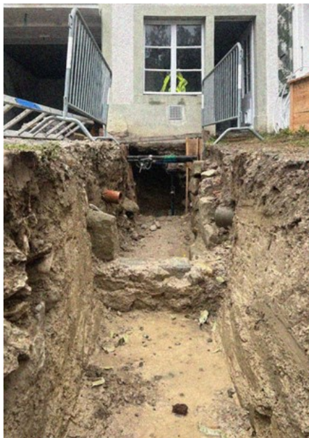
Fouille ouverte et passage de mur devant la cure, départ conduite CAD.
